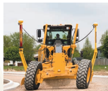
3D-Maschinensteuerung mit Laserunterstützung
